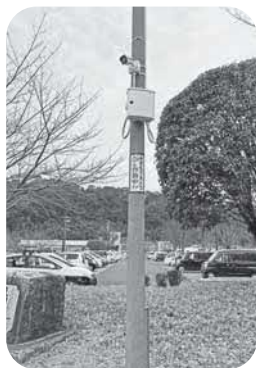
【防犯カメラの設置(甲佐町役場前)】
