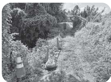
【「びわんくび」の現況 (写真左側が崖となっています)】
