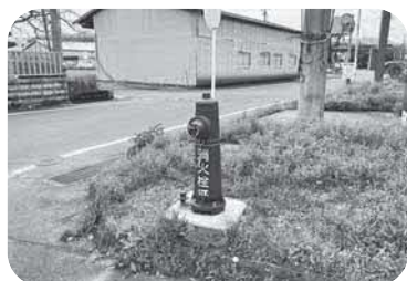
【豊内地区の消火栓】
