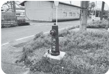
【豊内地区の消火栓】
