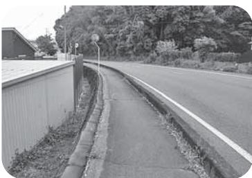
【町道津志田中山線 転落防止柵】
