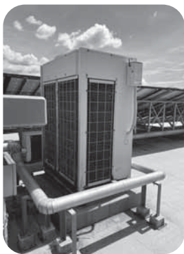
【庁舎空調設備の一部】
