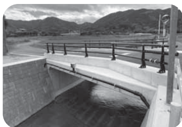
【令和3年度に実施した幸野橋の水道管添架状況】
