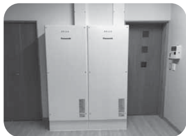
【乙女高齢者福祉センター蓄電池写真】
