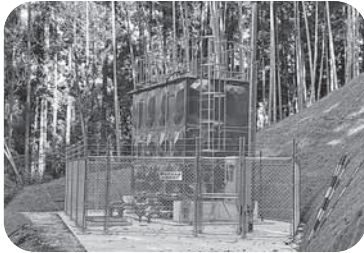
【令和2年度に新設した小鹿配水池】
