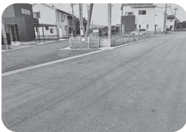
【液状化対策として道路内に排水管を整備した芝原団地】
