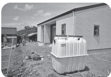
【新築住宅に設置される合併処理浄化槽（5人槽）】
