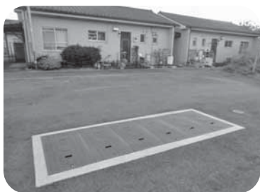
【吉野団地に新たに設置した合併浄化槽】
