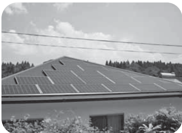
【住宅の屋根に設置された 太陽光発電】
