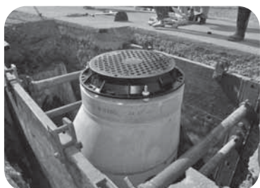
【芝原地区に整備した地下水位低下施設】
