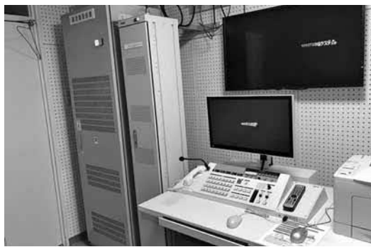
役場庁舎1階に設置してある防災行政無線親局
