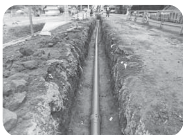
【令和4年度に実施した町道西寒野打越線の水道管布設状況】
