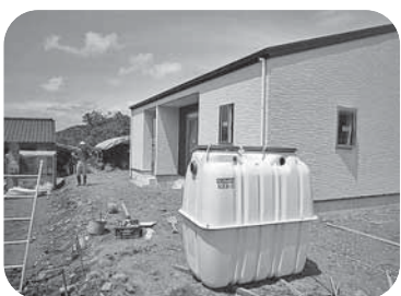
【一般家庭に設置される合併処理浄化槽】
