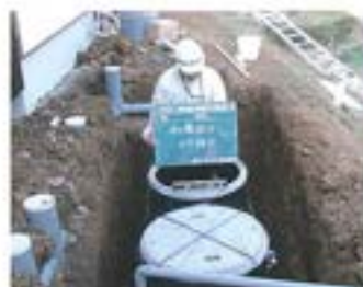
合併処理浄化槽
