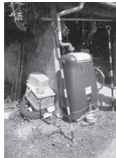
雨水貯留タンク
