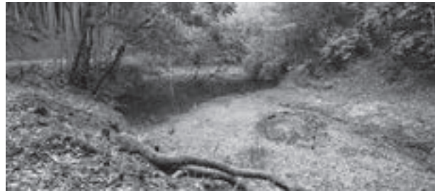
早期改修が望まれる堤
