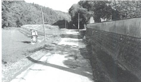
早急な改良が望まれる町道山口甲佐線
