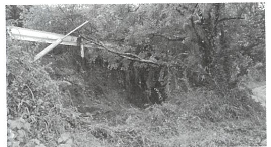
災害復旧（被災状況）
