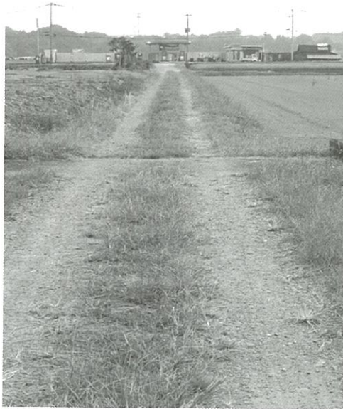
改良工事が望まれる町道吉田県道線
