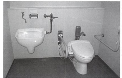
左側がオストメイト対応トイレ
