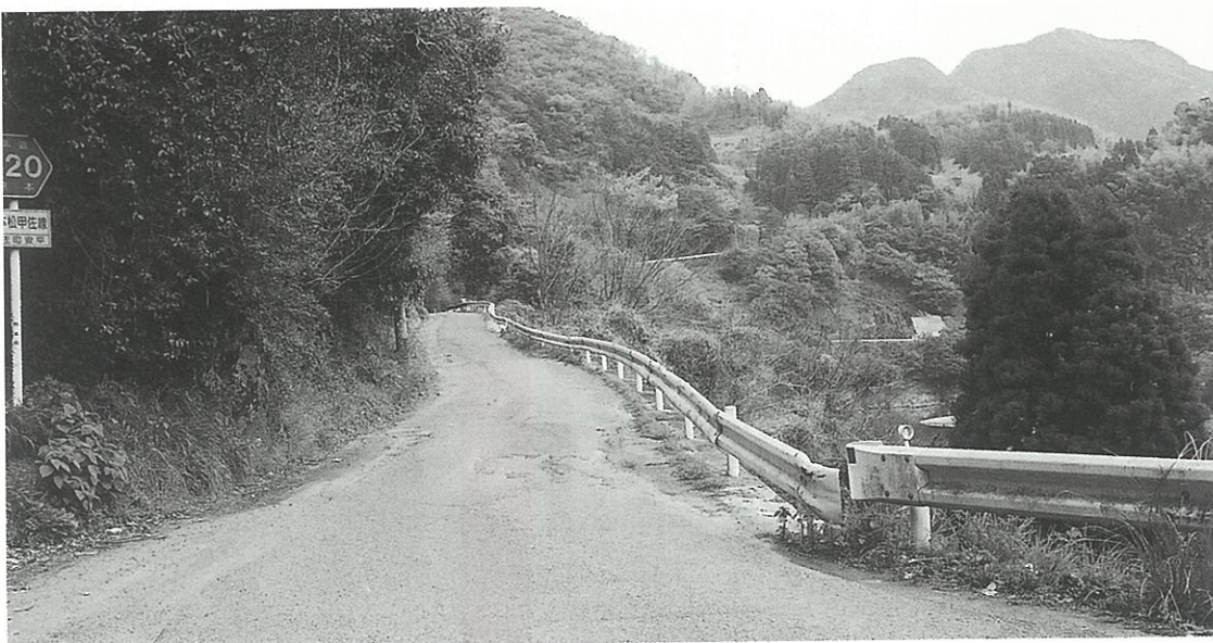
防災工事の施工が望まれる県道三本松甲佐線
