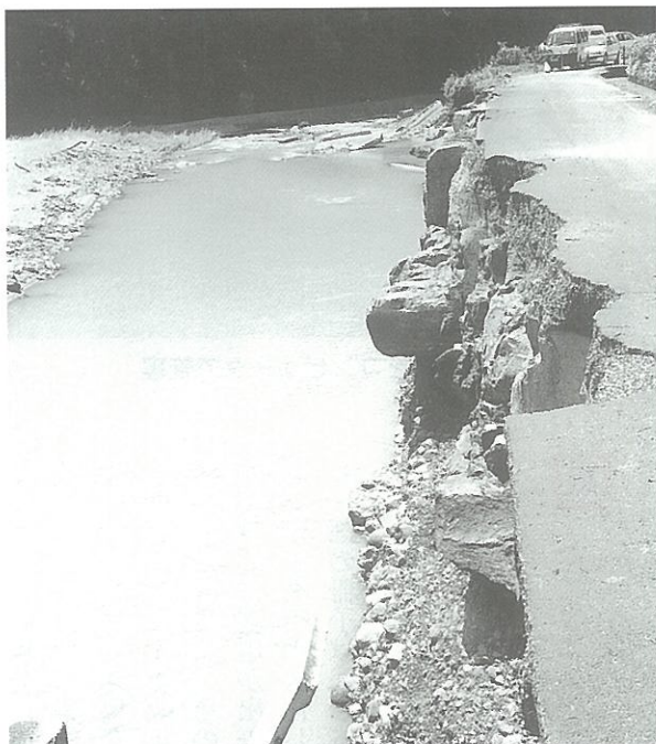
町道西小川島線の災害
