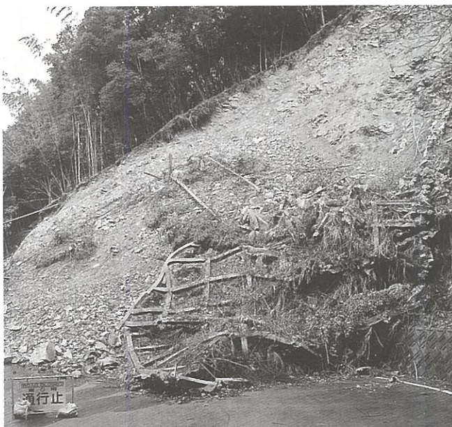
林道山上幹線の災害現場
