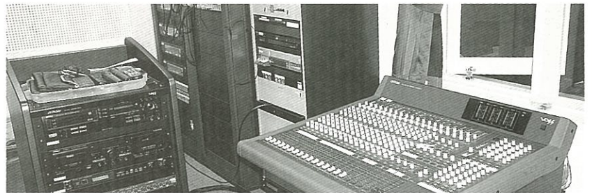
イベント時に使用される各音響施設
