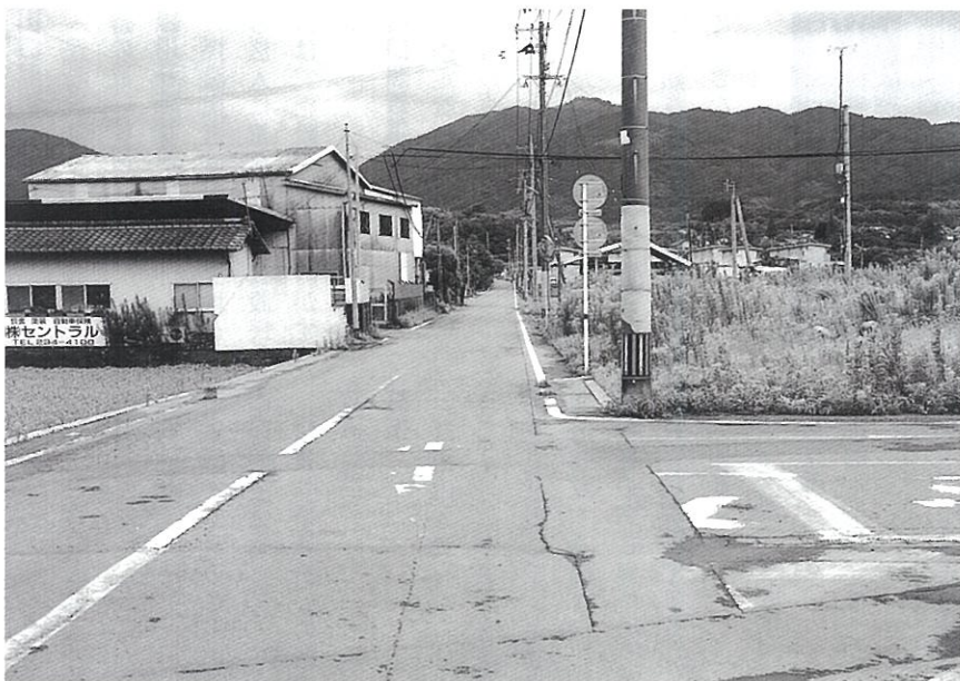
歩道が望まれる町道 作替・内田線
