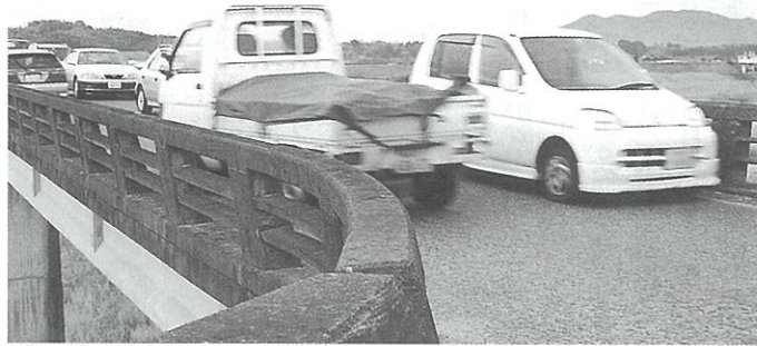
幅員が狭いために交通量が増え、通行に支障をきたしている田口橋
