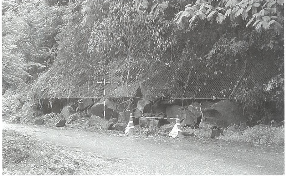
本板谷の災害現場
