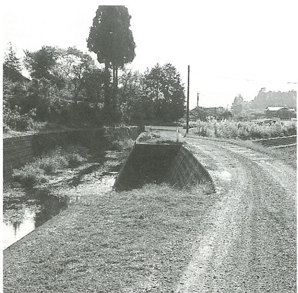
道路舗装や危険箇所改良が待たれる町道城平橋大谷線
