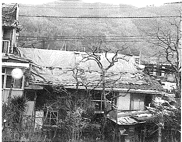
台風18号は多くの家屋にも被害を与えた
