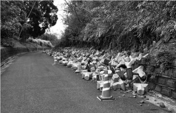
崩壊したブロック積（中山）
