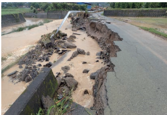
川の増水によりえぐられた町道（上早川）
