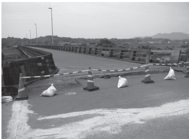
復旧が待たれる田口橋
