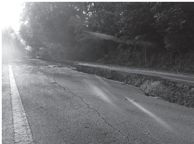
数十センチの段差ができた県道宇土甲佐線（田口）
