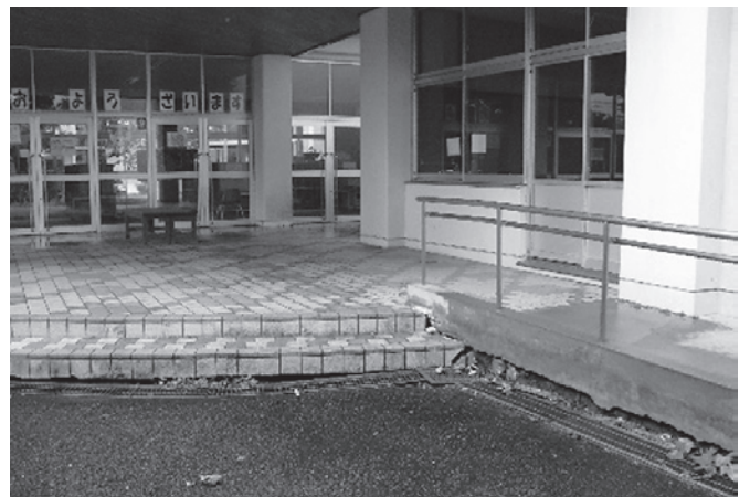
被災した乙女小学校玄関
