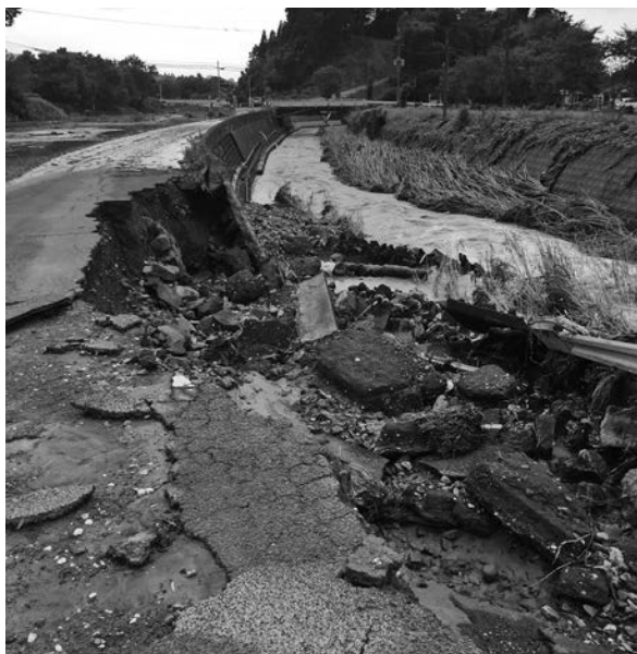
越水により被災した竜野川
