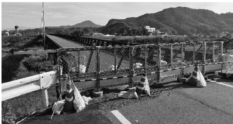
復旧が待たれる田口橋
