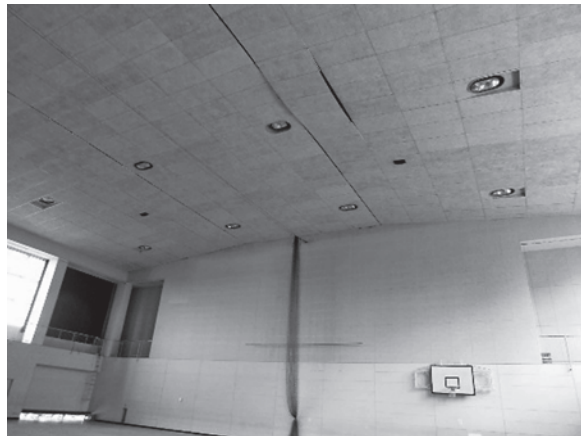
落下の危険があるトレセンの天井
