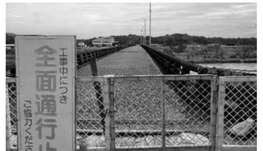
通行止の田口橋
