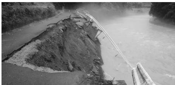
町道西小川島線被災状況
