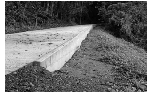
災害復旧後の農道 (下田口)
