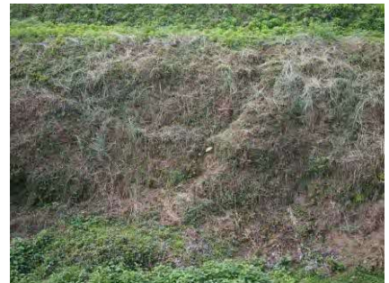
写 4-3 堀斜面のき損箇所
