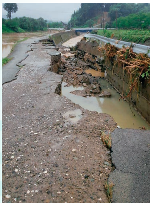
▲龍野小学校下四叉路周辺の道路崩壊
