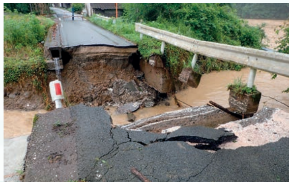
▲県道三本松甲佐線(上揚地区)の橋梁流出
