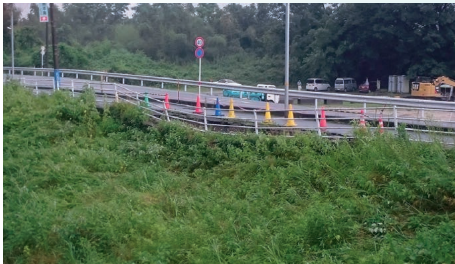
▲白旗小学校前歩道の崩壊
