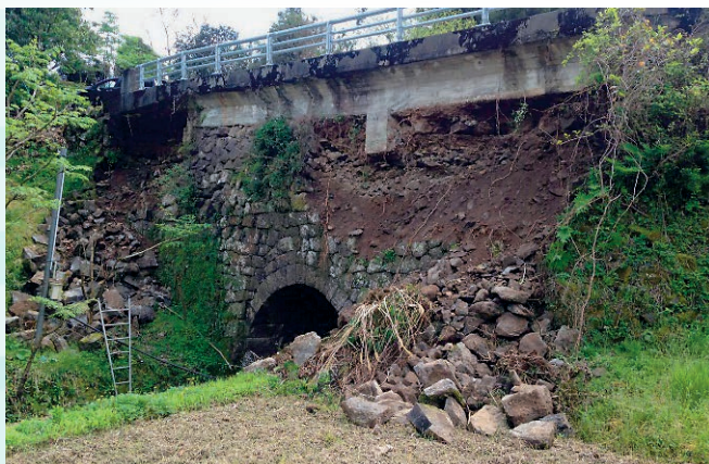
▲御手洗橋の破損(安平地区)
