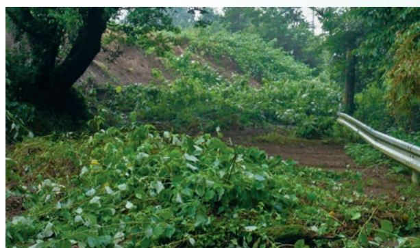
▲町道津志田山口線の道路寸断
