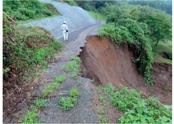
▲下豊内地区の農道のり面崩落
