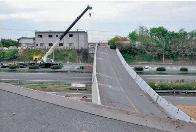
▲府領橋の落橋
