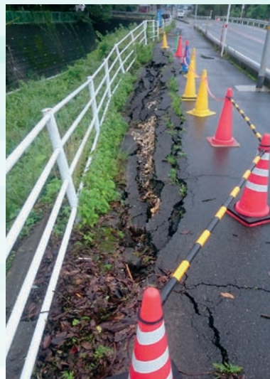
▲白旗小学校前歩道の亀裂
