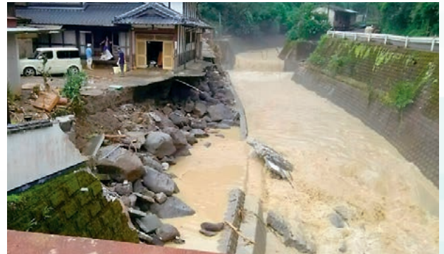
▲坂谷川氾濫による護岸崩壊
