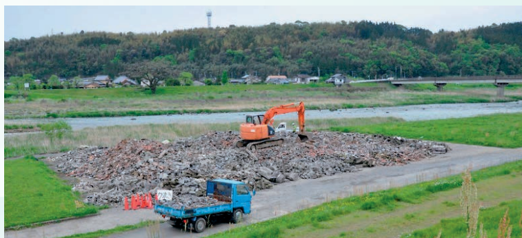
▲中甲橋グリーンパークの災害ごみ集積状況
