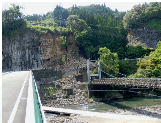
▲県道三本松甲佐線の土砂崩れ(南から)
