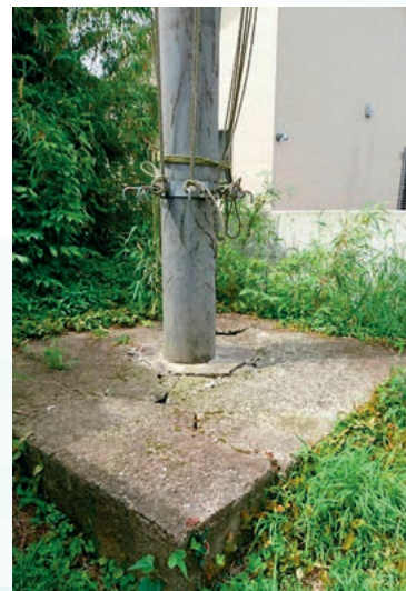
▲消防ホース乾燥塔の基礎破壊と傾斜(府領地区)
