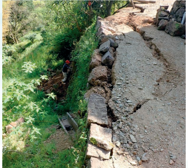
▲堂ノ原地区の宅地被害
