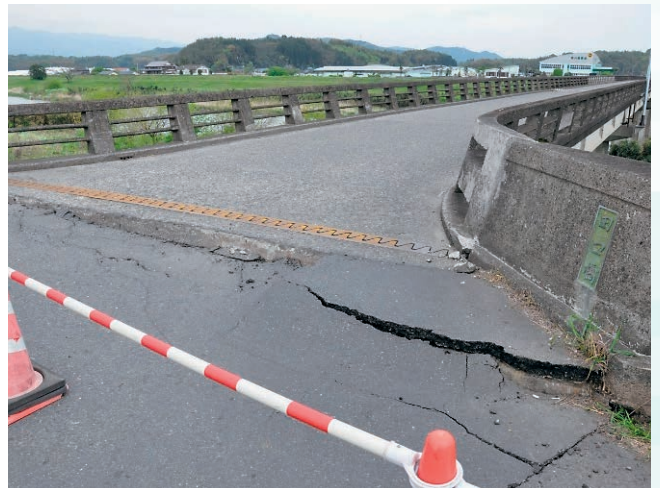
▲田口橋の破損
