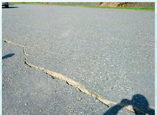
▲町営白旗グラウンド駐車場の亀裂
