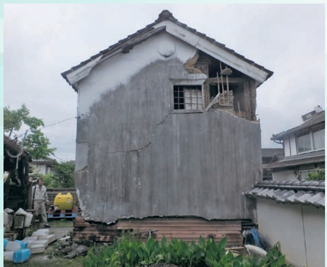
▲蔵の壁崩落(旧西村民俗資料館裏)
