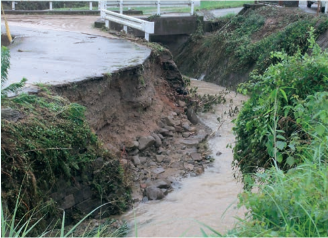
▲町道田代線の護岸崩壊
