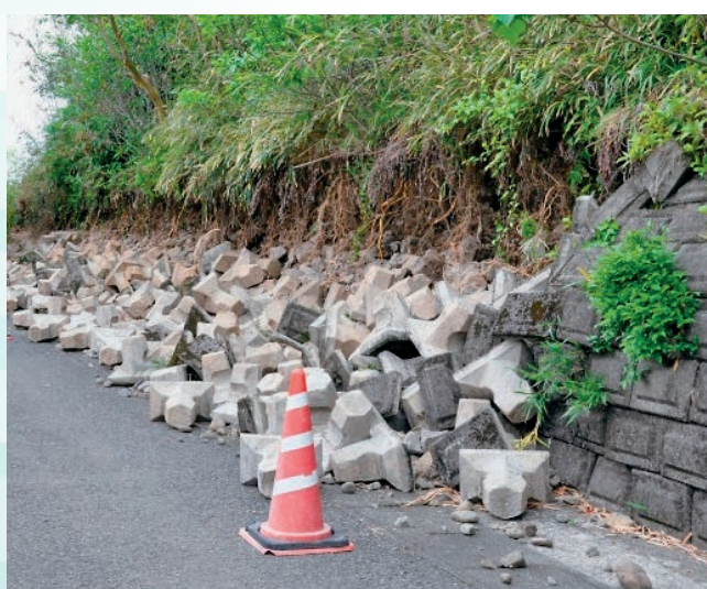
▲町道中山県道線の擁壁崩壊
