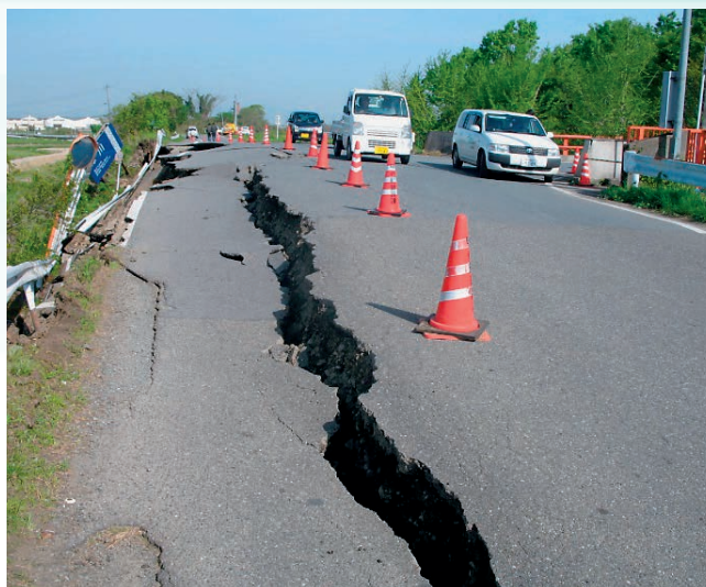
▲県道宇土甲佐線の道路亀裂
