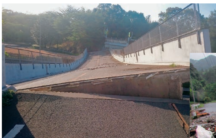
▲地震により落下した府領橋
