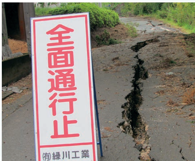
▲町道松ヶ崎妙見谷線の亀裂被害
