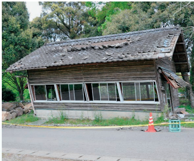
▲家屋の倒壊(グリーンセンター)
