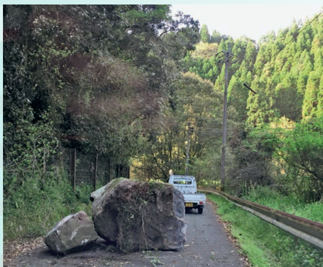
▲町道坂谷線の落石被害
