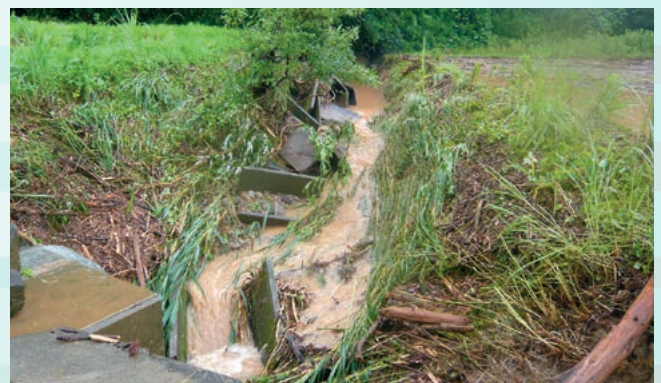
▲船津山口地区の水路崩壊
