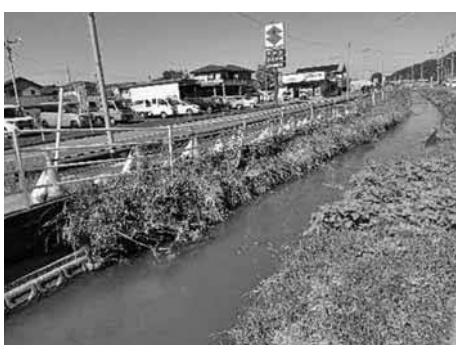
歩道が陥没 国道443号（下横田地内）
