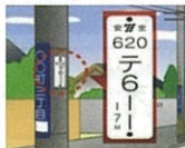
電柱の管理番号
