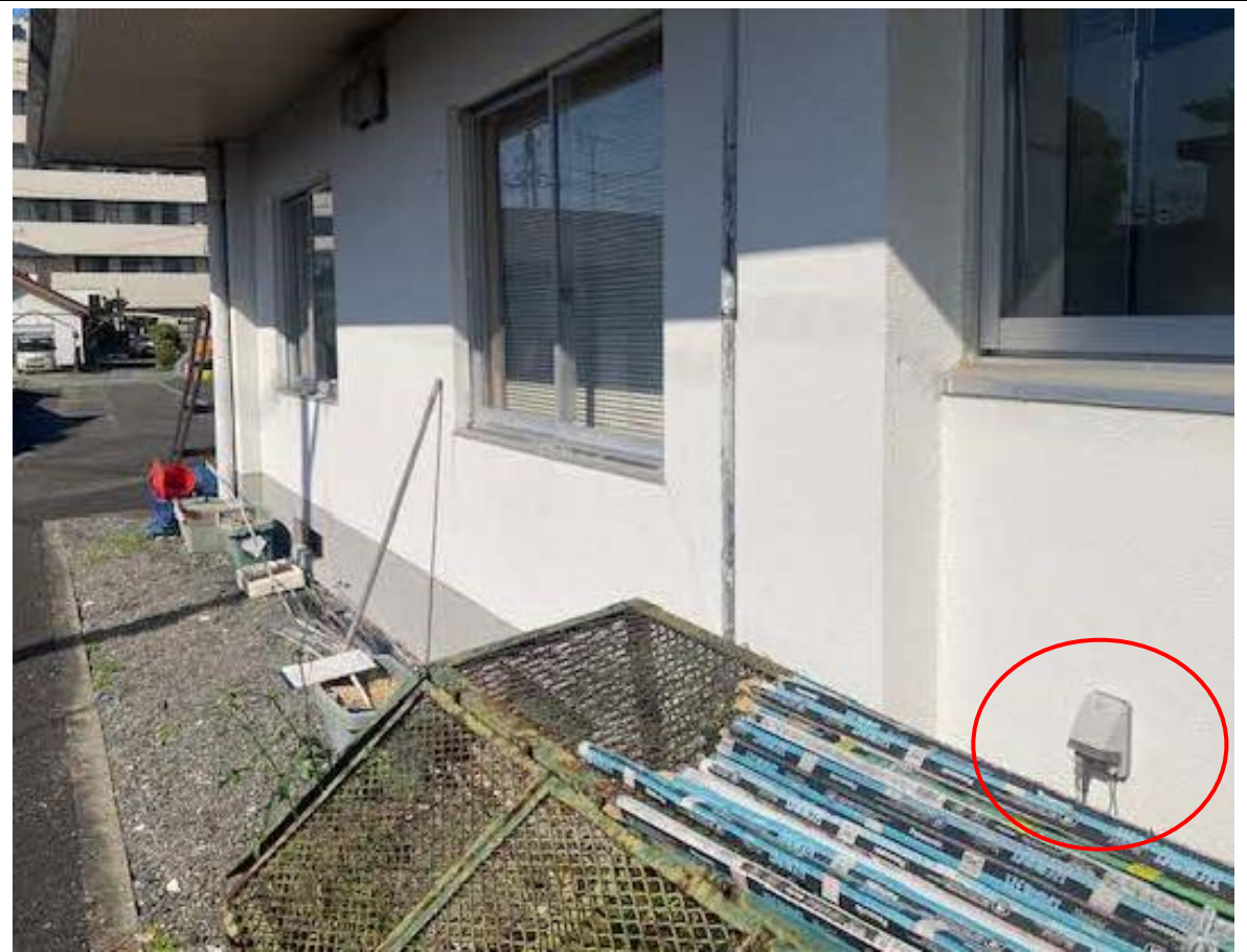
施設外部電源（近景）
