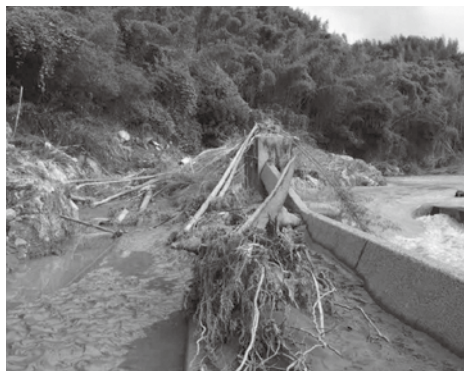
被災した鹿生田堰頭首工
