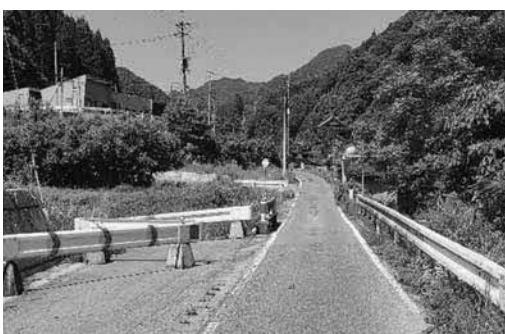
県道三本松甲佐線上揚住宅前付近の状況
