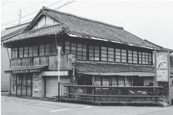
▲市街地に大井手川が流れる甲佐ならではの風景を楽しめる宿泊施設へ改修中の旧松永たばこ店
