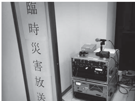
▼避難所や車中泊で避難している被災者などに利用していただくために町本庁舎に開設した災害F.M局
